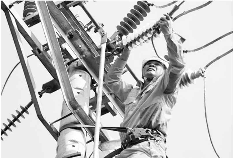
Công nhân Công ty điện lực chi nhánh huyện Yên Bình vận hành lưới điện.
